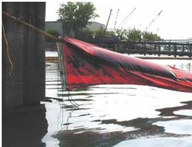
▲ 図16：長さが不十分な係留索を使用すると、干潮時にオイルフェンスが宙吊り状態になり、下部を油が通り抜けられる。潮周期を通じてオイルフェンスが効果的な位置に保たれるように、定期的に索を調整する必要がある。この場面では、スライド式の係留装置がより効果的である。
