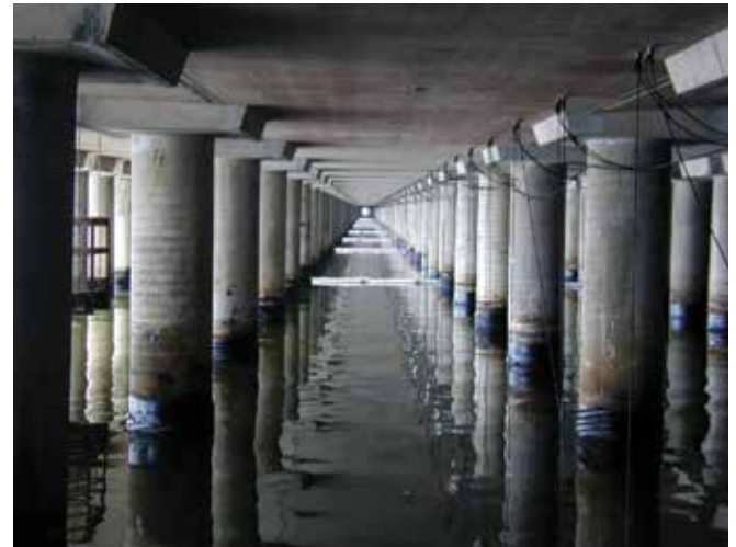
▲ Şekil 5: İskelelerin altına erişim, yeterli boşluk payı ve havalandırma olmaması nedeniyle temizlik personeli için güç ve tehlikeli olabilmektedir.
