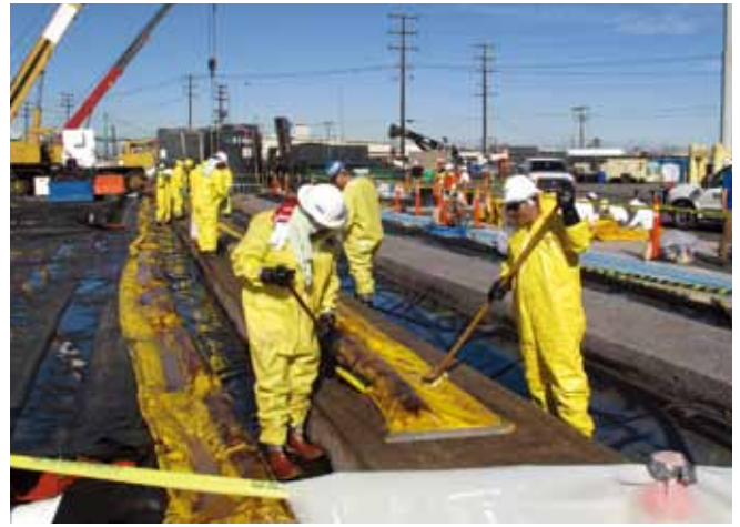
▲ 图 12: 在可能的情况下，应该对设备进行清洁和维修，以便在下次事件时可供调动。
